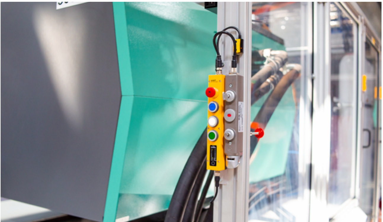
Safety Simplifier mit Euromap-Schnittstelle an einer Spritzgussmaschine.
